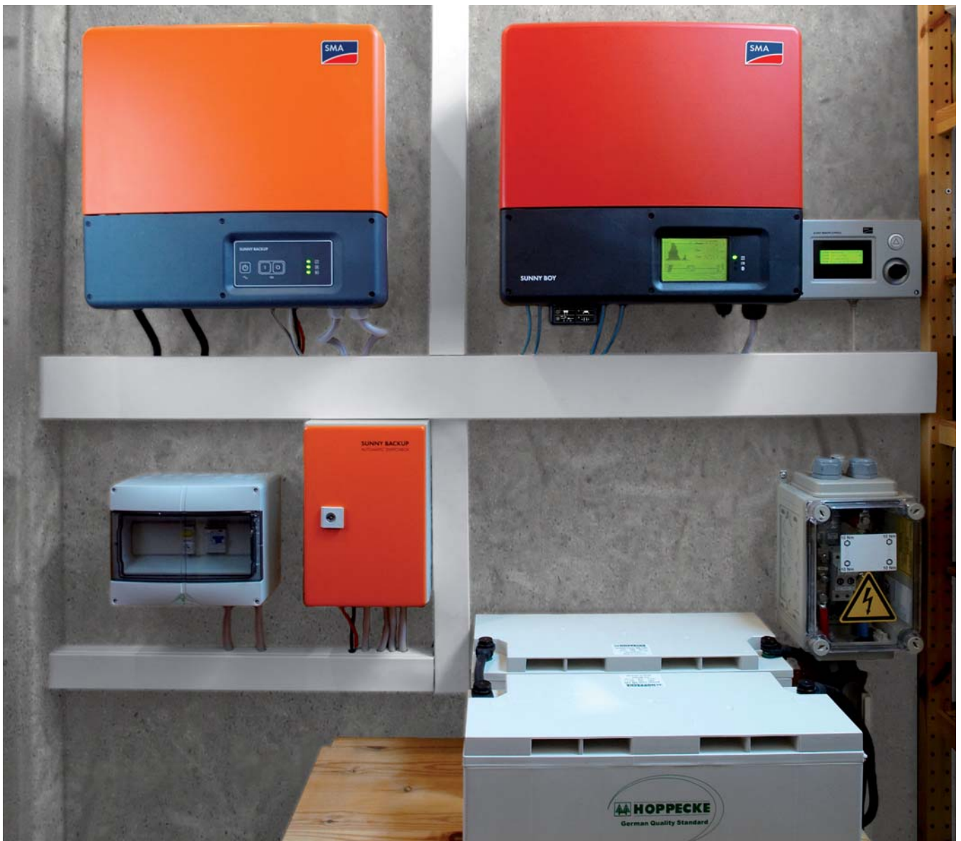
Abb. 3: Hightech für maximalen Eigenverbrauch – das Sunny Backup-System von SMA
